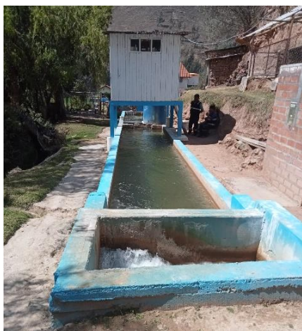
Llegada al sedimentador
