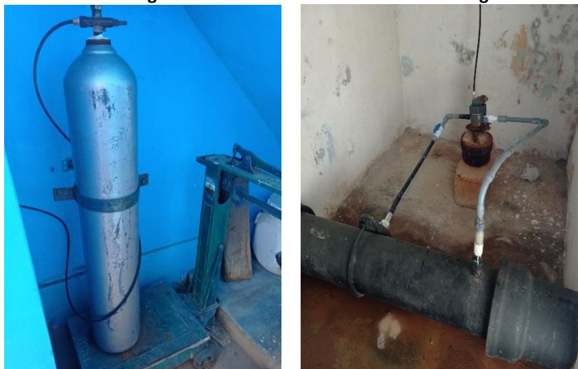
Imagen N° 16: Sistema de cloración con cloro gas
