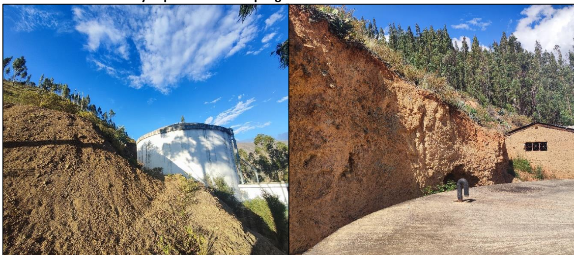
Imagen N° 31: Reservorio de San Martín y Reservorio Tucuhuajana, cercanos a un talud pronunciado y expuestos ante el peligro de movimiento en masa.
